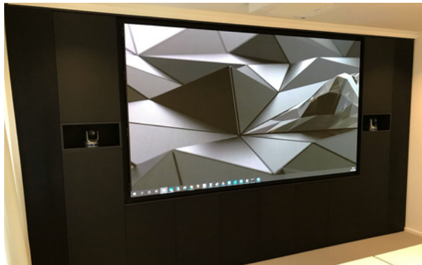
Das Wanddisplay besteht aus 3 x 6 Elementen von Samsung. Passend dazu sind 2 Linienstrahler und 2 PTZ-Kameras links und rechts der LED-Wand platziert.
