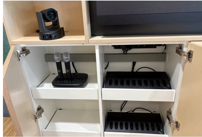
PTZ-Kamera und drahtlose Handmikrofone sind sicher in der Technikmöbelung untergebracht und jederzeit einsatzbereit.
